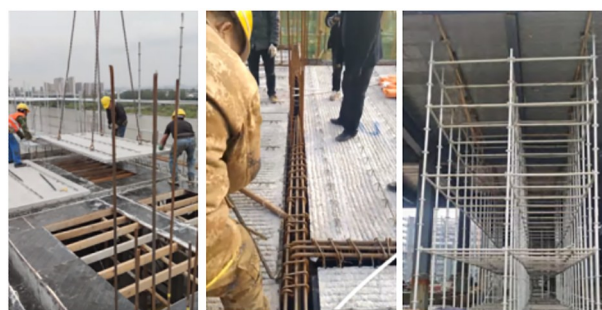
(a) 板跨小、接缝多 (b) 梁板钢筋冲突 (c) 板底支模量大
